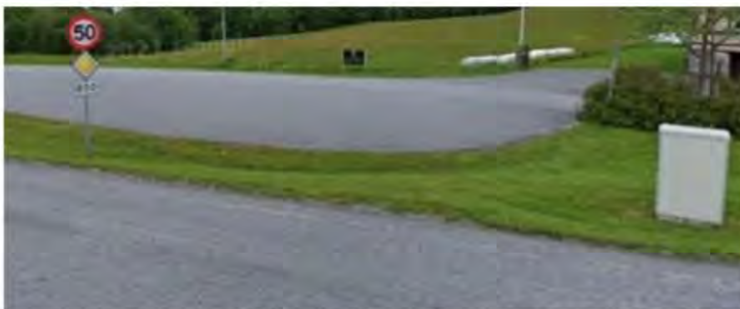
Figur 3: Tennskap (sikringsskap) som inneheld strømmålar, for veglysanlegg er vist til høgre i bildet (fv. 650).
